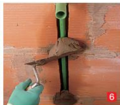
6) fixace vodovodních potrubí
